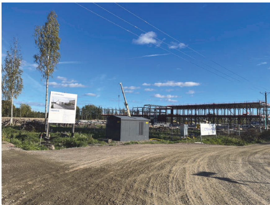
圖 1：位於芬蘭科沃拉市（Kouvola）一處小村莊內的資料中心建築工地
